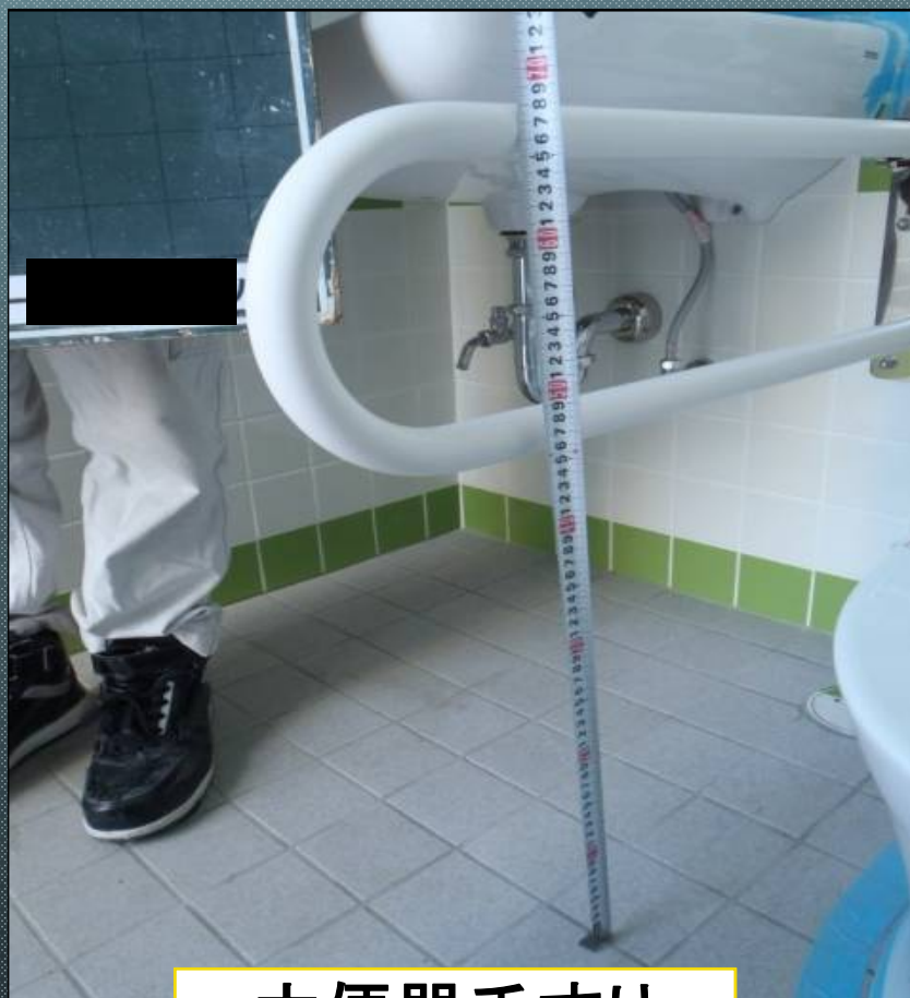
大便器手すり
