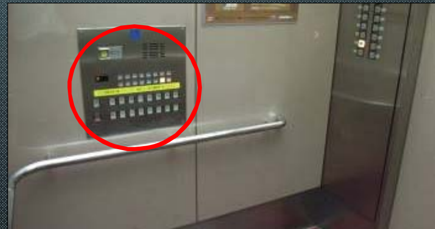
18 エレベーター内 操作盤
