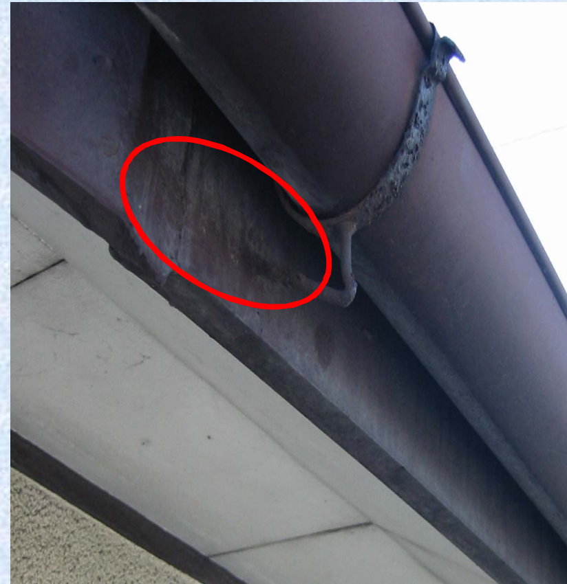
庇枠材劣化(塗装劣化)に伴う 樋のズレ
