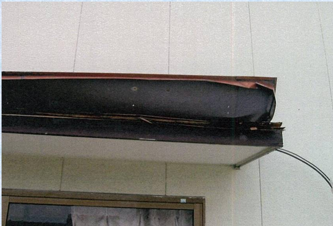
屋根下地材簿劣化による 鉄板の巻き上げ
