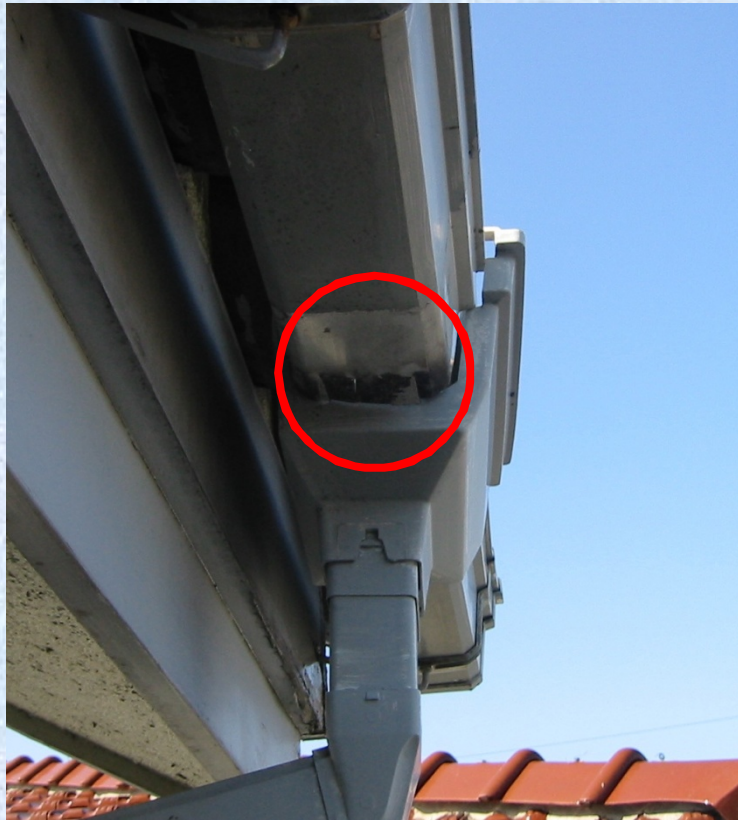
庇枠材劣化(塗装劣化)に伴う 樋のズレ
