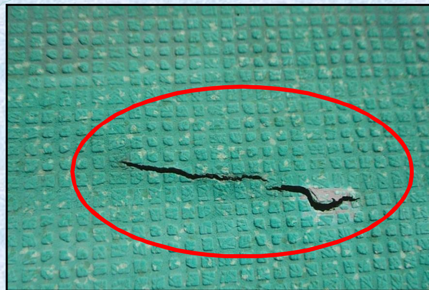
防水シートの破れ接写
