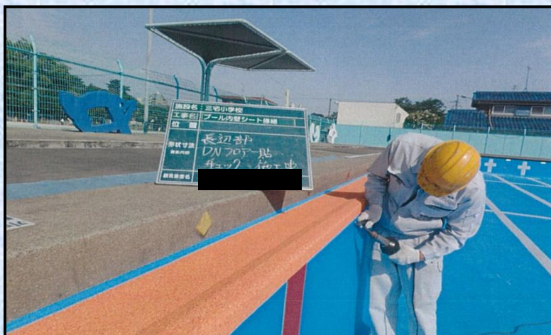
①オーバーフロー、プールサイド部分
