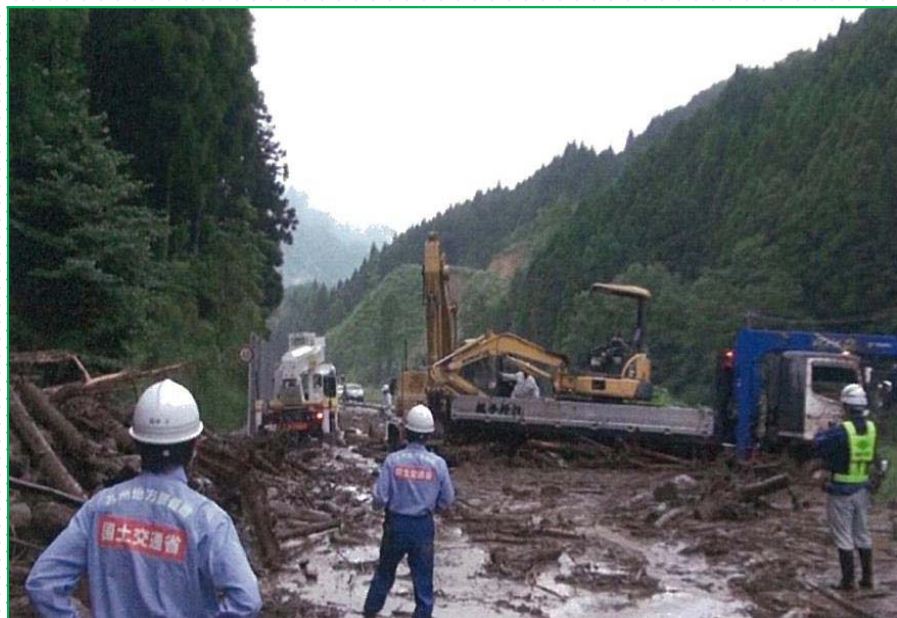
豪雨による被災車両の撤去状況（福岡県東峰村）
