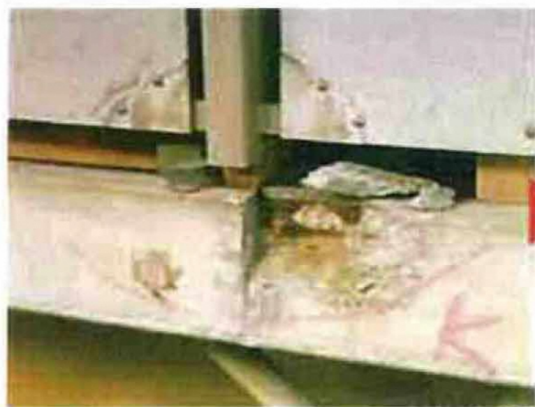
バルコニーの欠落部分
