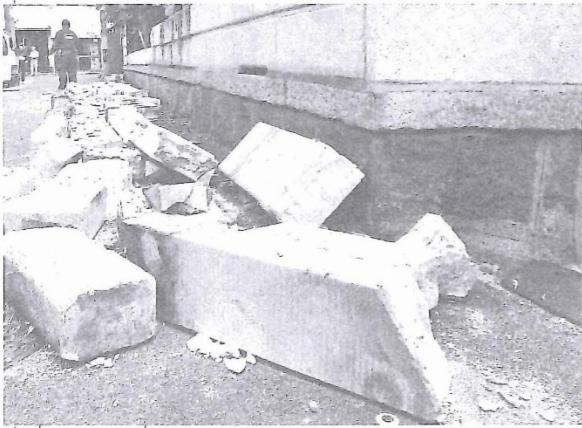
地震で崩れたブロック塀 (6月18日、大阪市東淀川区)
