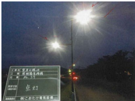
夜間点灯状況の確認
