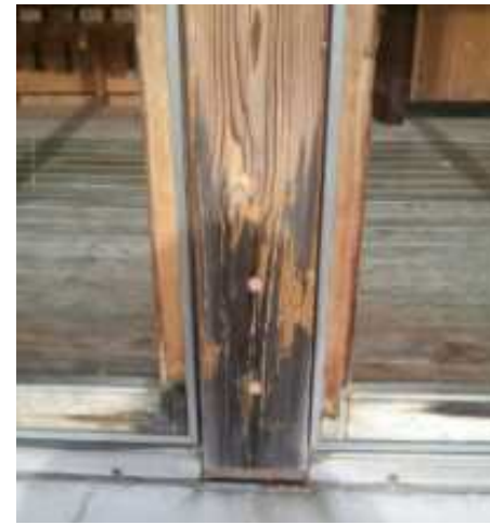
柱脚部の腐朽例
