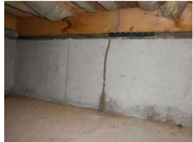
基礎、土台部分の蟻害の例
