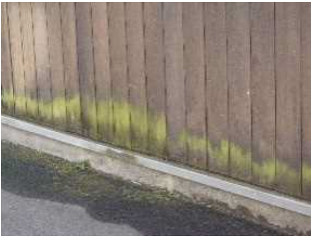
壁面に発生した腐朽例
