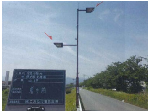
既設照明器具
