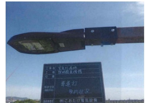
新設照明器具(LED) 取付状況
