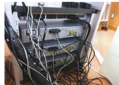
新設放送卓配線状況
