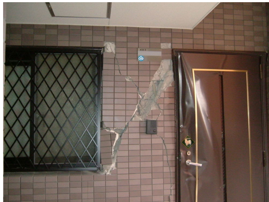
非耐震壁の被害 (ドアが開かない)
