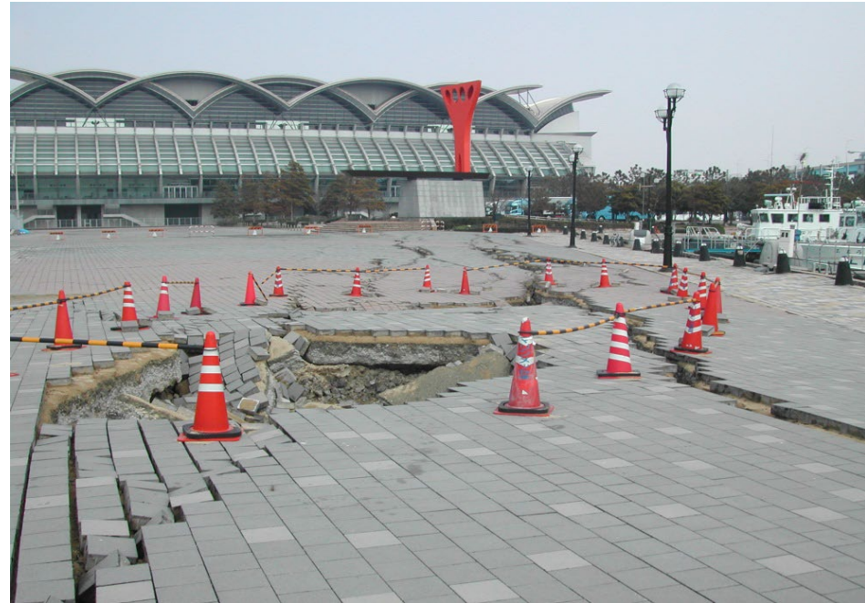
地盤の液状化被害
