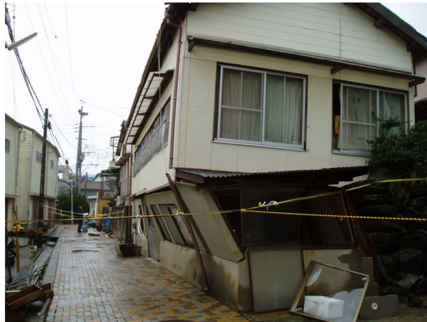
1階部分の倒壊
