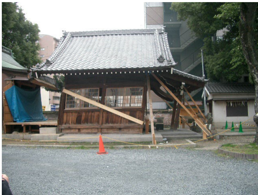
古い木造建築物の被害
