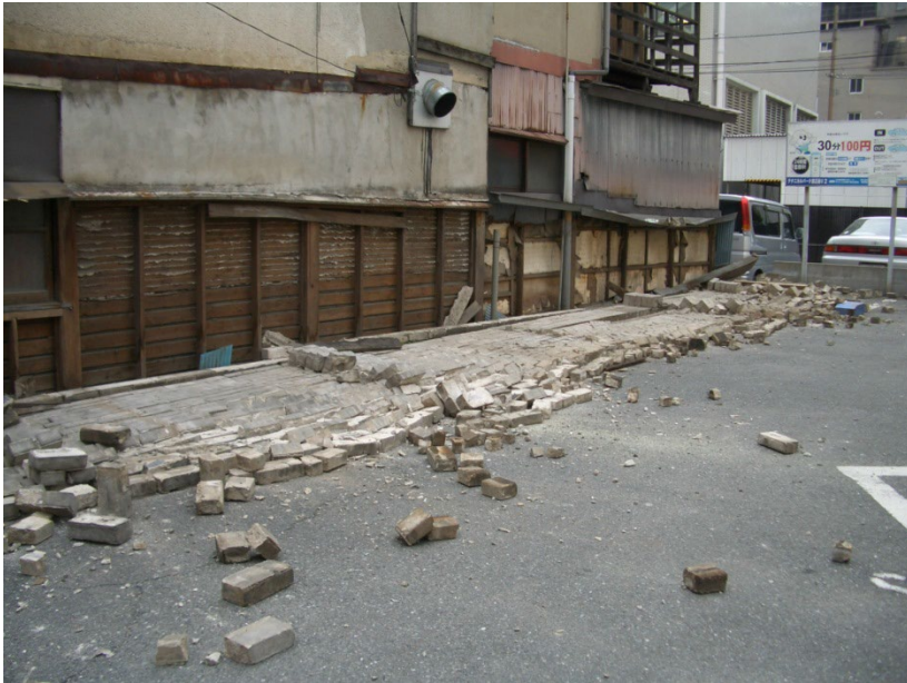
ブロック塀の倒壊
