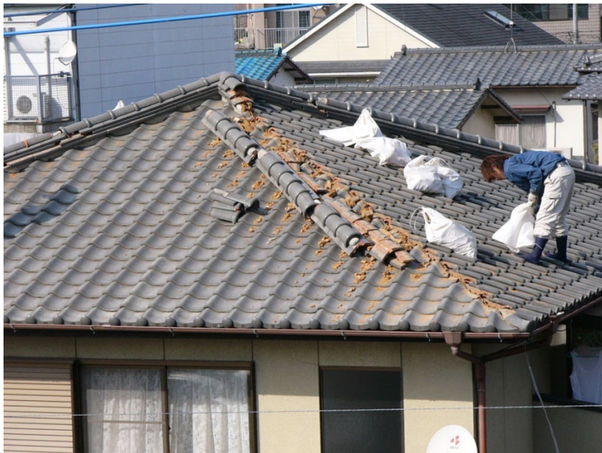
屋根瓦の被害
