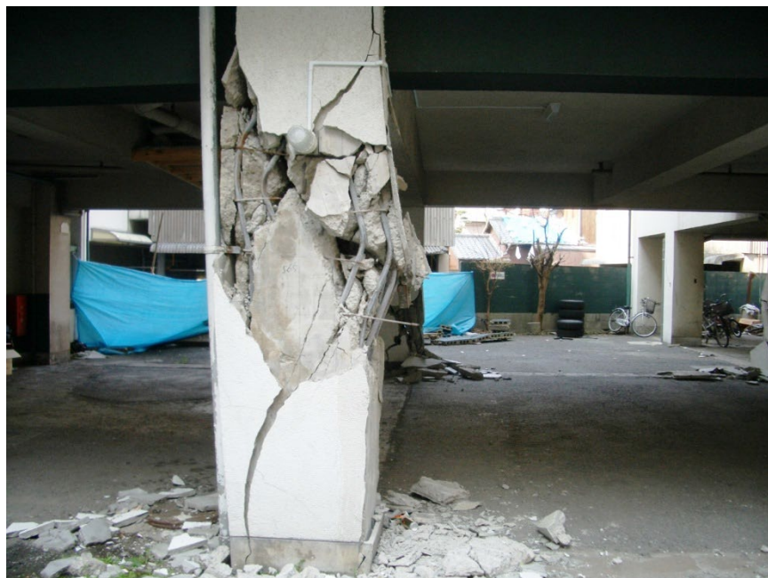
マンション1階柱の被害 (ピロティ柱)
