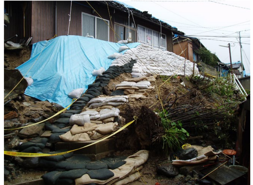
がけ崩れ等の地盤被害
