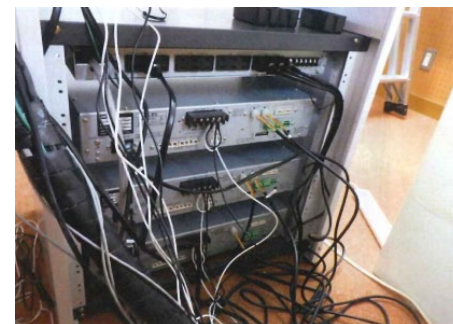
新設放送卓配線状況
