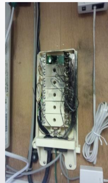
【落雷による電話引込線の焼損】
