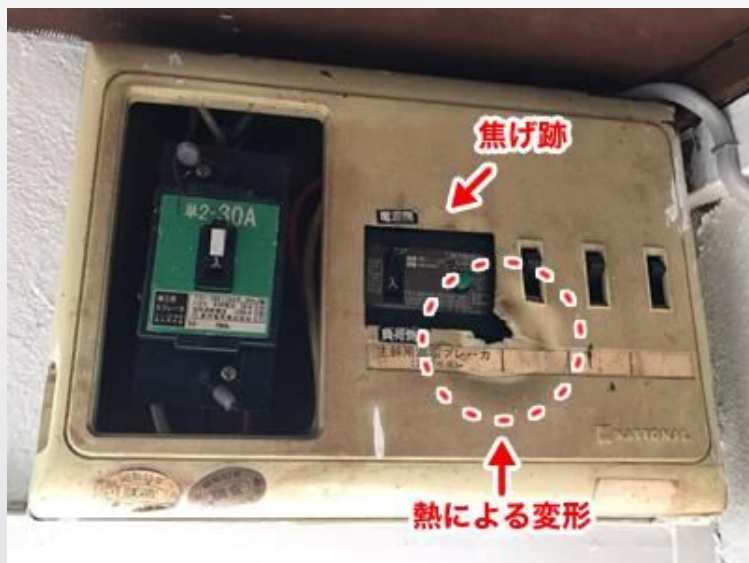
【ブレーカーの劣化で異常発熱】
