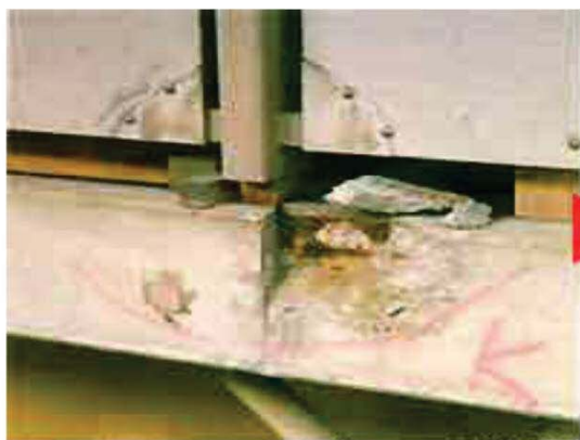
バルコニーの欠落部分
