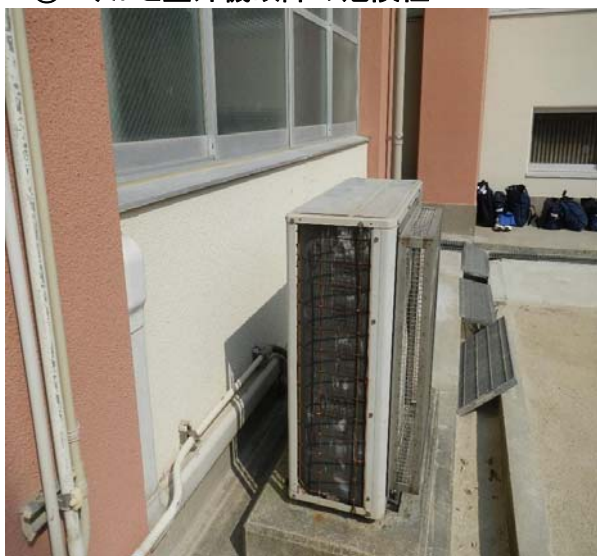
サイドパネルカバーの脱落
